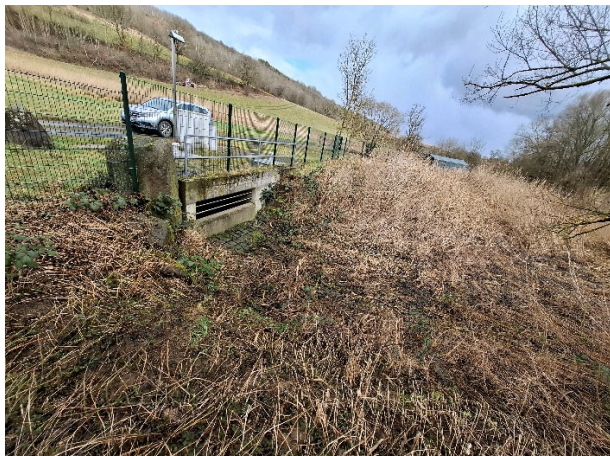
Überlauf Entlastung Staukanal zu Bodenfilter
